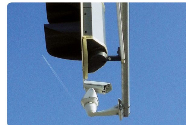
Návěstidlo SSZ a kamera dohledového subsystému.
