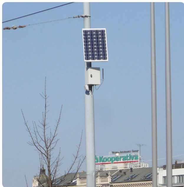
Umístění datových kolektorů na ul. Rooseveltova.
