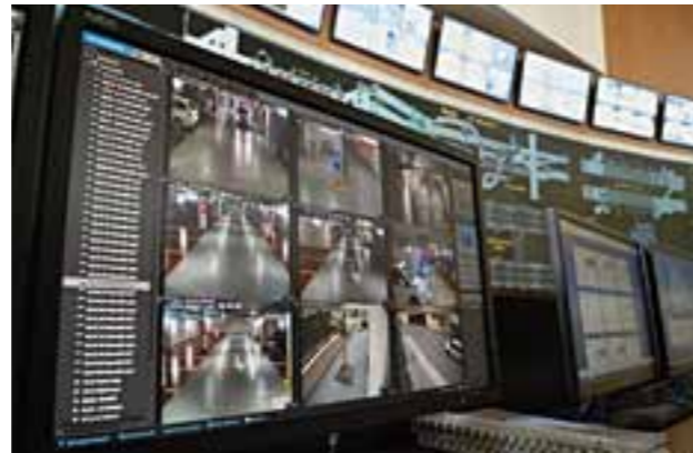
Pracoviště Centrálního technického dispečinku BKOM.
