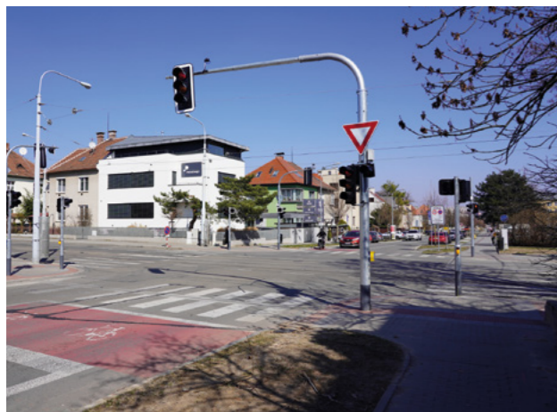
Křižovatka 7.18 Purkyňova – Dobrovského, rekonstrukce světelné signalizace je součástí projektu Řízení dopravy a sběr dopravních dat ve městě Brně, 5. etapa.
