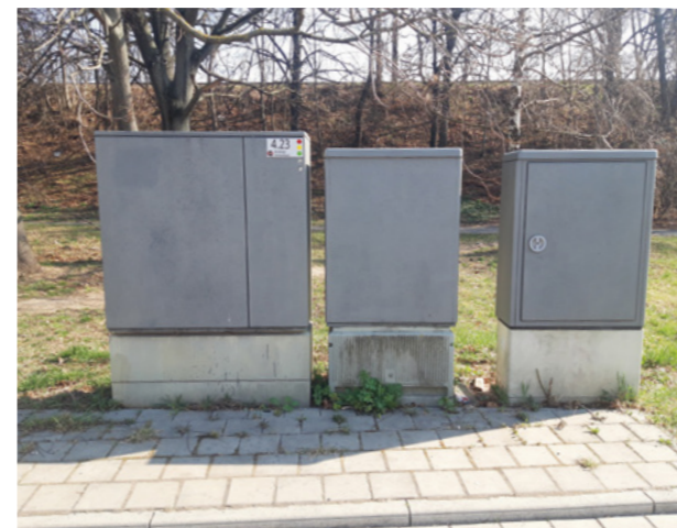
Řadič SSZ ošetřený ochranným nátěrem.
