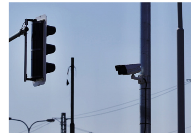
Kamerový dohled na křižovatce Úzká - Uhelná.
