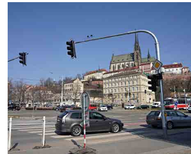
Křižovatka 0.44 Hybešova – Nádražní, rekonstrukce světelné signalizace je součástí projektu Řízení dopravy a sběr dopravních dat ve městě Brně, 2. etapa.
