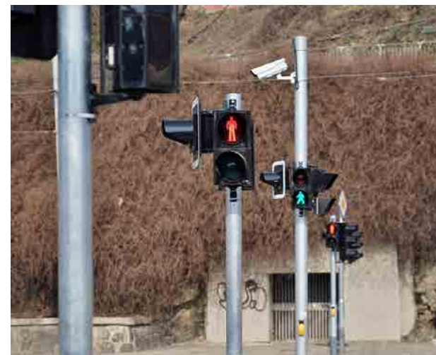
Přechod křižovatky 0.06 Husova – Nádražní, rekonstrukce světelné signalizace je součástí projektu Řízení dopravy a sběr dopravních dat ve městě Brně, 2. etapa.
