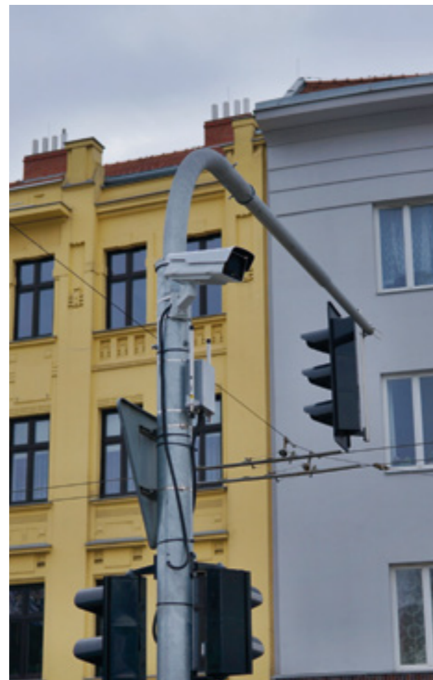
Kamerový dohled na křižovatce Mendlovo nám. - Křížová.
