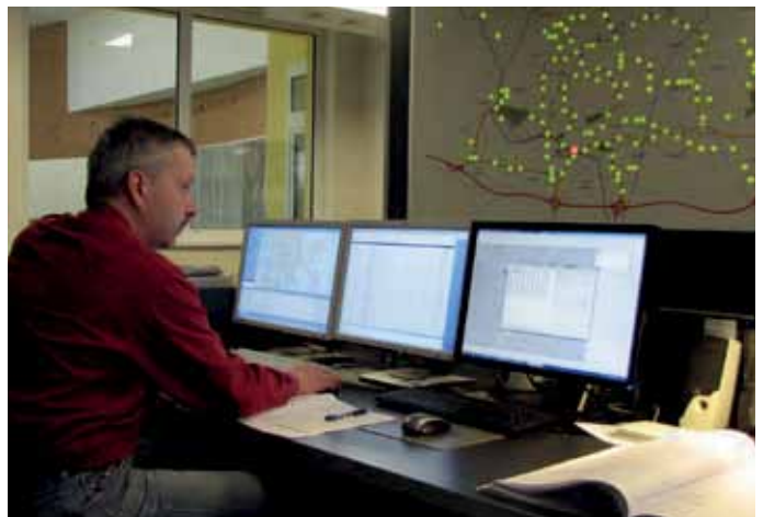
Klientské dopravně-inženýrské pracoviště modernizované dopravní ústředny SSZ
