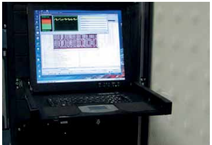
Servisní konzola modernizované dopravní ústředny SSZ
