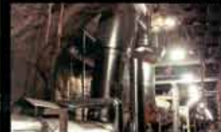
Primární kolektory Brno - Tkalcovská
