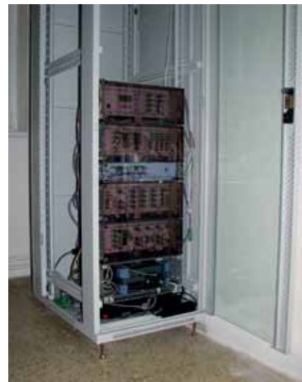
Zařízení aktivního monitoringu optických kabelových sítí pro řízení dopravy v rozvodně Centrálního technického dispečinku
